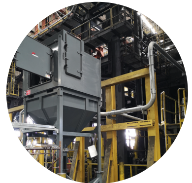
DHV-HOPPER MIT ROHRLEITUNGSNETZ
